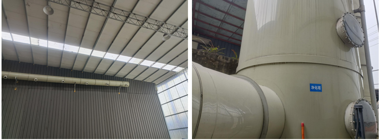
图2-11 迁建前废气集气及处理设施
