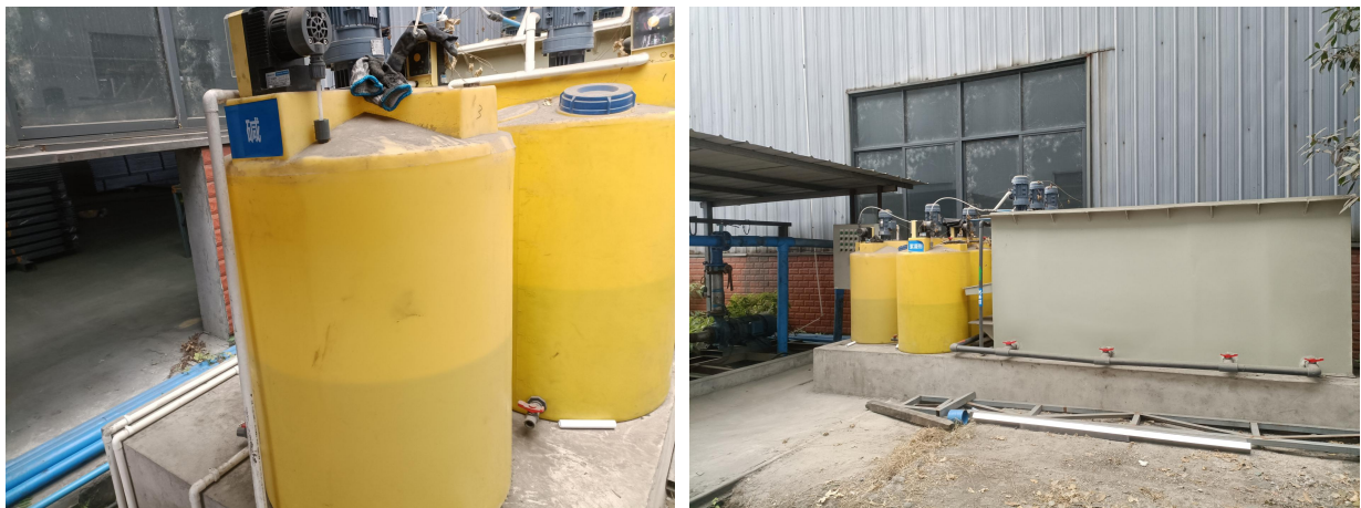
图2-12 迁建前一体化污水处理设施
